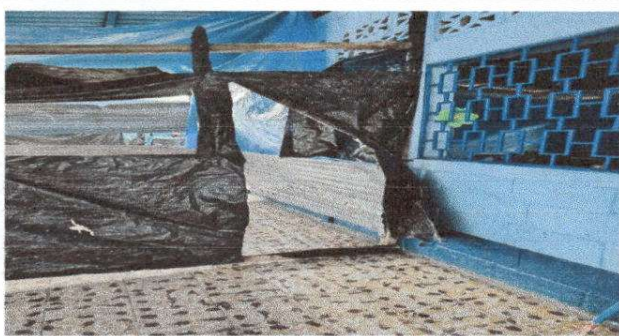
Foto 1: Sustrucción de puerta
